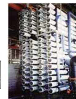
Unité de filtration pour la production d'eau potable
